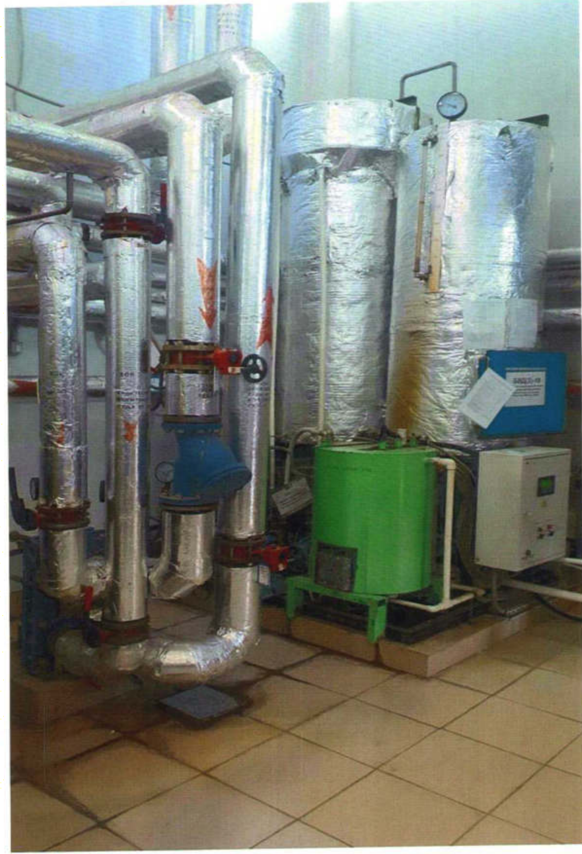
Автоматизированная вакуумная деаэрационная подпиточная установка БВД(З)-10
