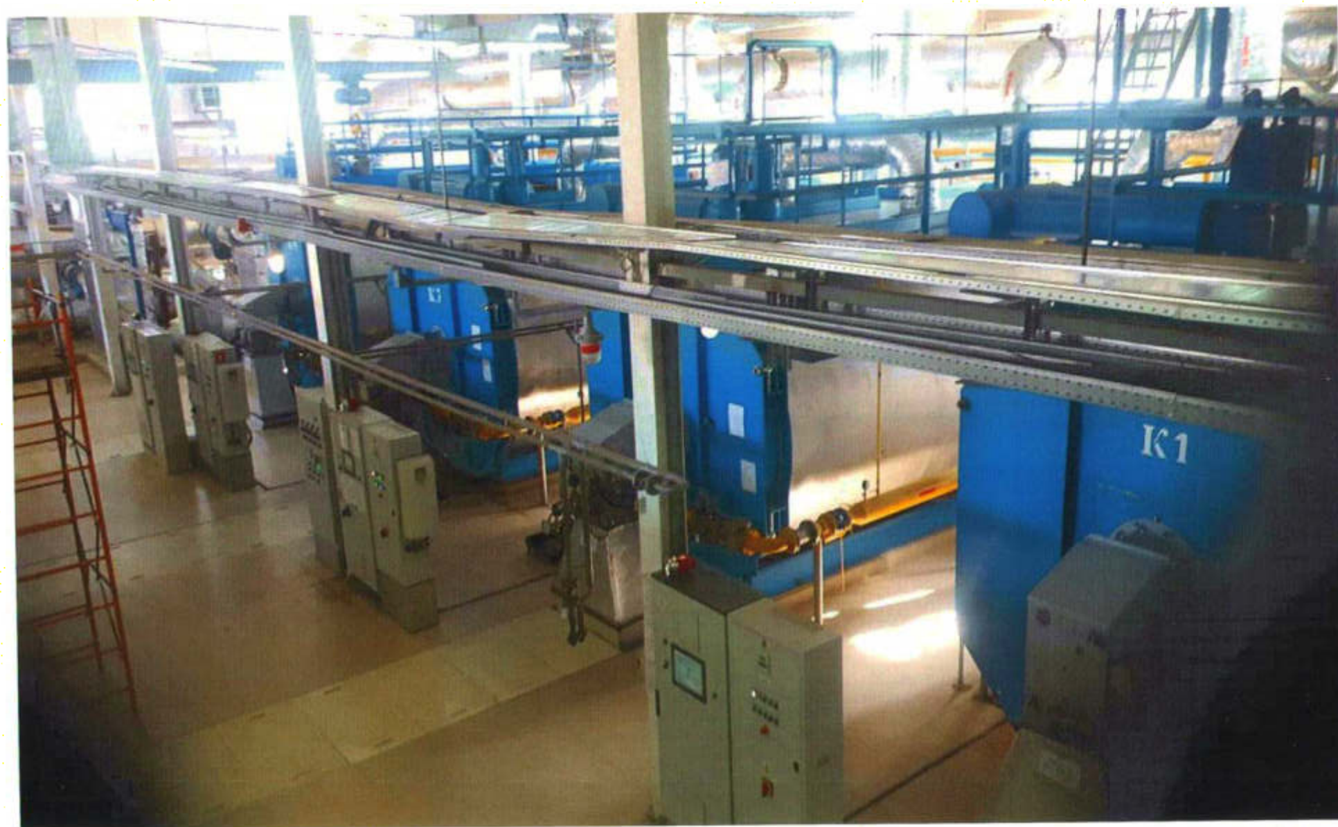
МАШИНЫЙ ЗАЛ КОТЕЛЬНОЙ КОТЛЫ №1,2,3,4
