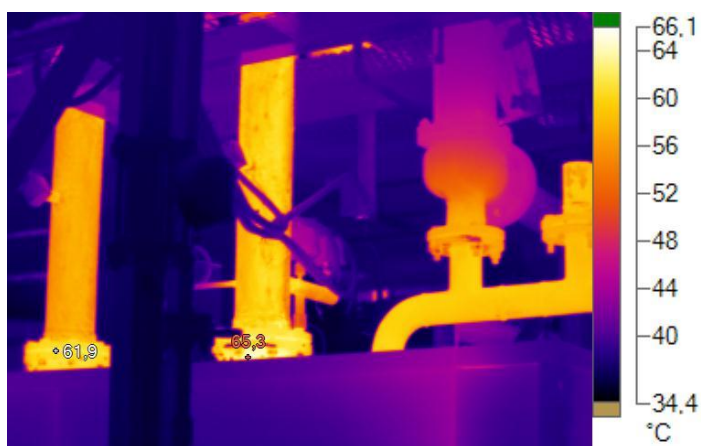
Термограмма № 2 – Отсутствие теплоизоляции на участках трубопроводов, расположенных по адресу г. Новосибирск, ул. Тайгинская, 1/5, к.8
