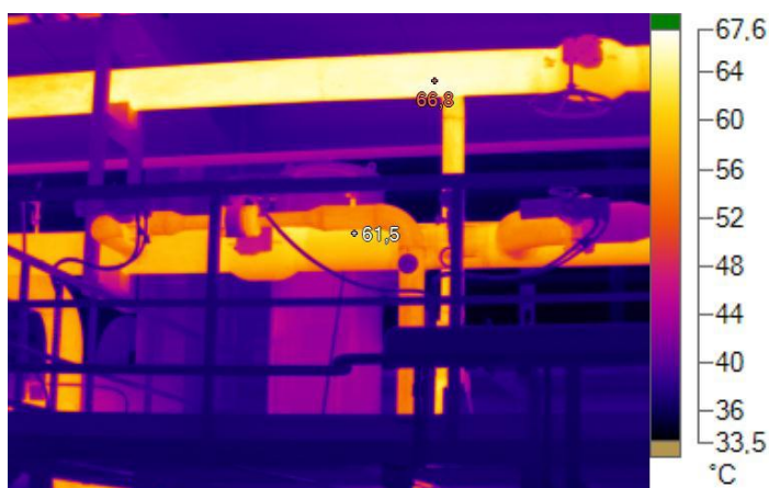
Термограмма № 4 – Отсутствие теплоизоляции на участках трубопроводов, расположенных по адресу г. Новосибирск, ул. Тайгинская, 1/5, к.8
