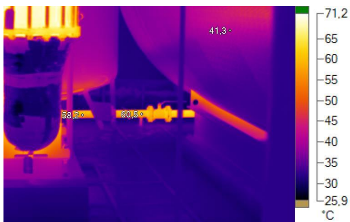
Термограмма № 1 – Отсутствие теплоизоляции на участках трубопроводов, расположенных по адресу г. Новосибирск, ул. Мясниковой, 14
