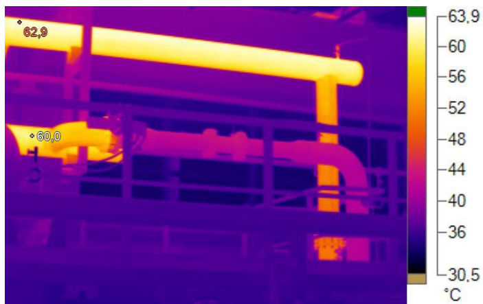
Термограмма № 5 – Отсутствие теплоизоляции на участках трубопроводов, расположенных по адресу г. Новосибирск, ул. Тайгинская, 1/5, к.8
